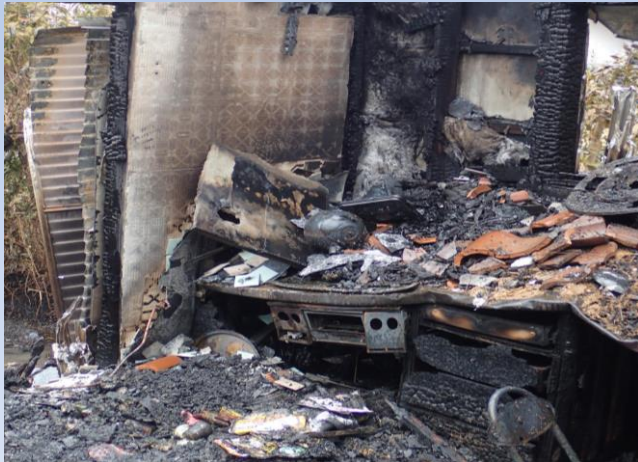
火災後の台所
